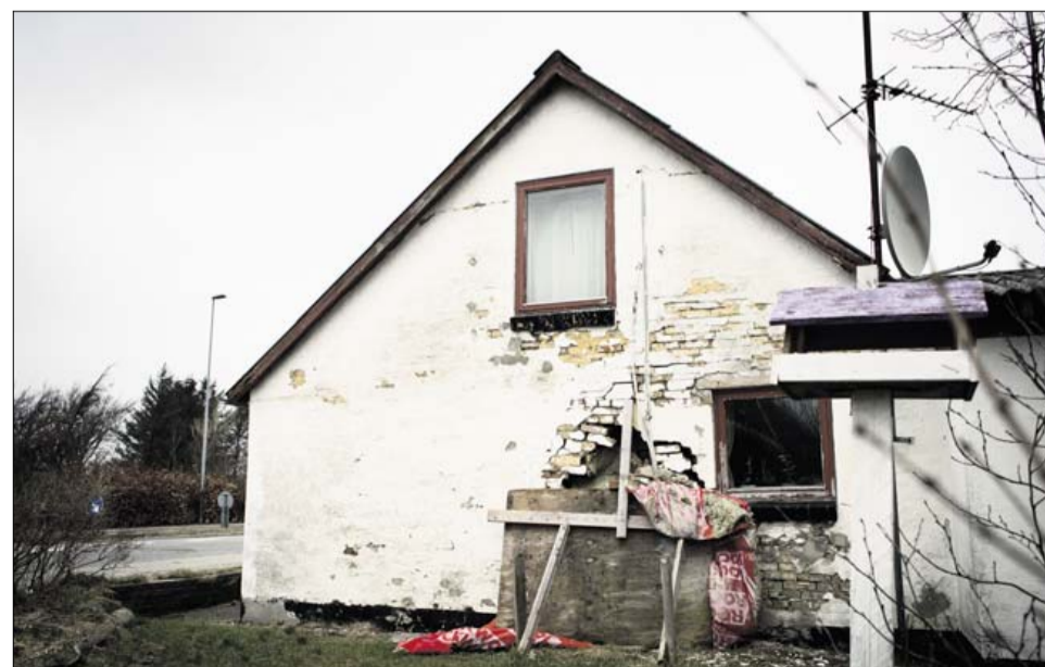
Faldefærdige huse hindrer udvikling på landet, og derfor skal der ryddes op, mener man i kommuneforeningen KL. Huset på Løkkensvej 777 i Hjørring har i årevis haft et stort hul i gavlen og er en af kandidaterne til nedrivning. Arkivfoto: Jens Henrik Daugaard
